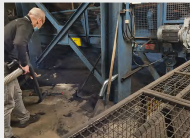
Aspiration de sable sous convoyeur
